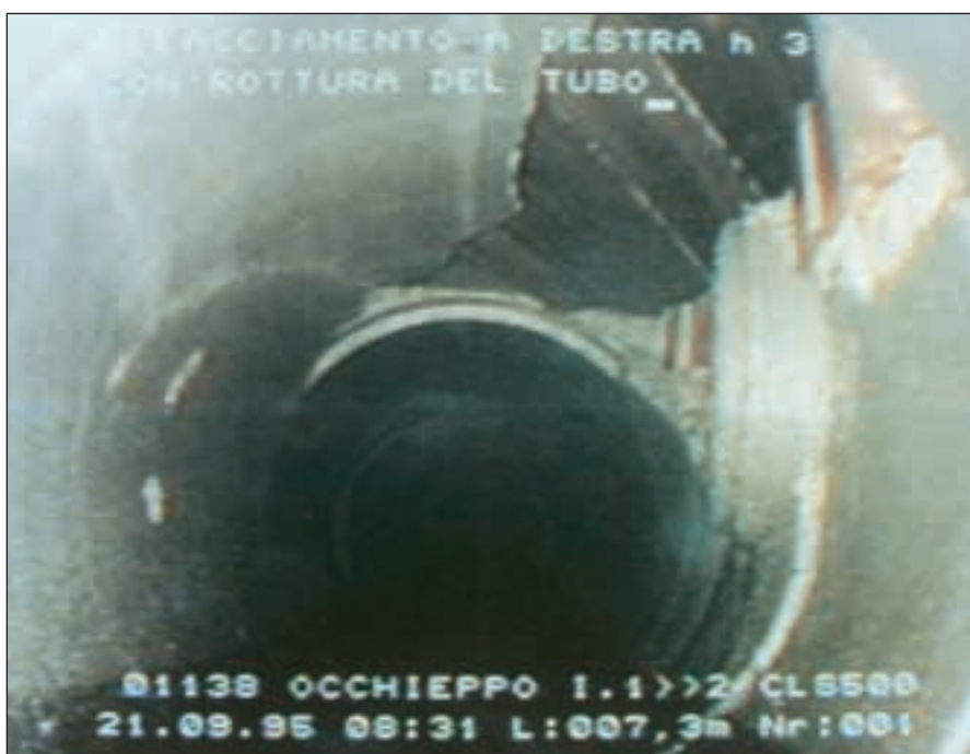
• Figura 13 - Tubazione in CLS Ø 500 allacciamento a destra, orientamento circa "ore 3" con rottura del tubo.
