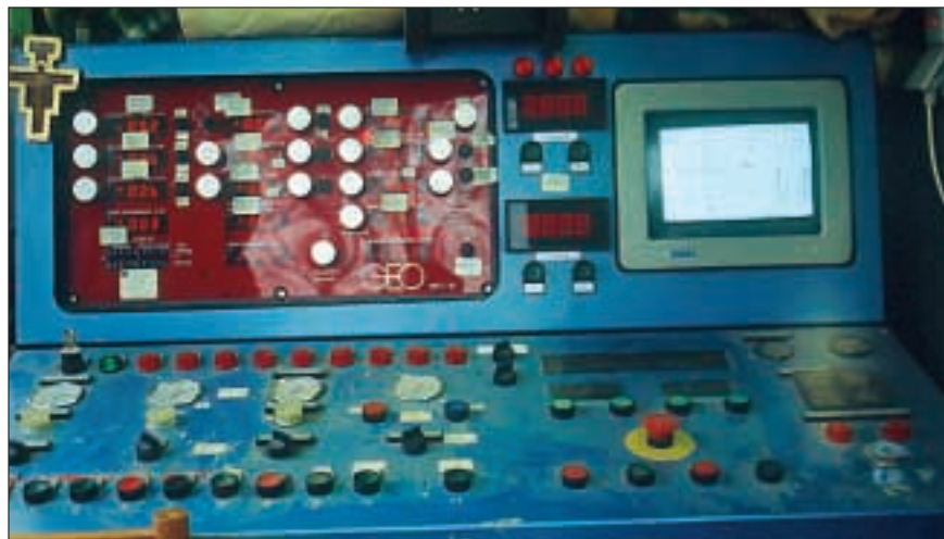
• Figura 7 - Particolare del quadro di comando e controllo.
